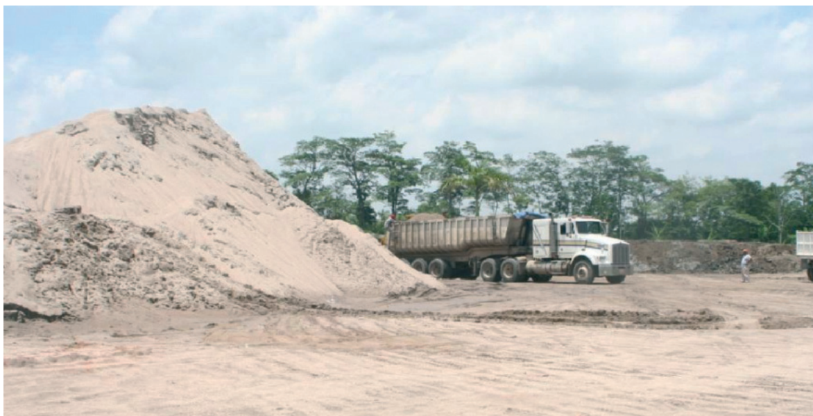
Figura 33. Extracción de arena y modificación del entorno físico en los márgenes del río Samaria en Cunduacán, Tabasco.
