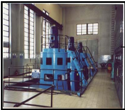
Estaciones Elevadoras Rebombeos de Agua
