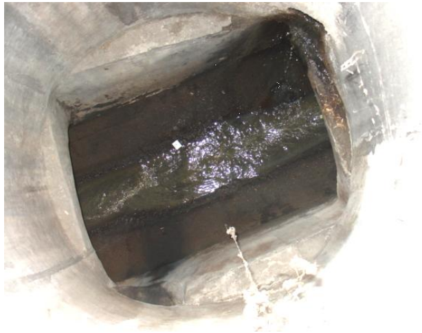
Figura 3. Inspección al drenaje, encontrando agua limpia por fugas en la red de abastecimiento de CU.
