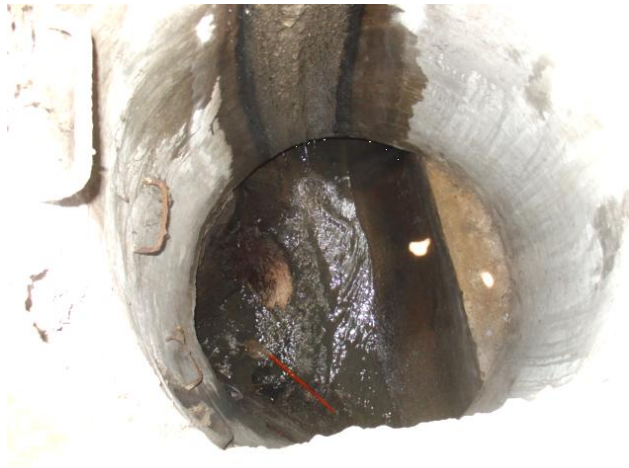
Figura 4. Inspección al drenaje, encontrando agua limpia por fugas en la red de CU.
