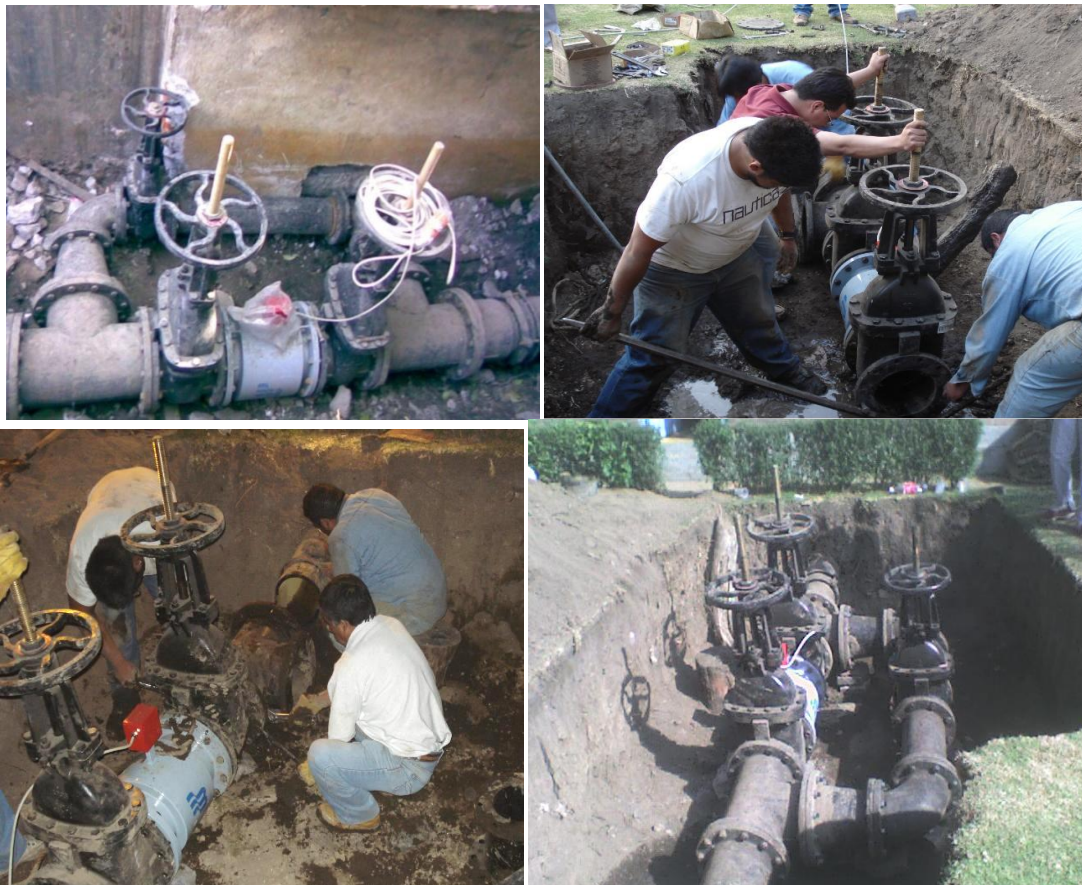
Figura 1. Instalación de Medidores Electromagnéticos en 2008.
