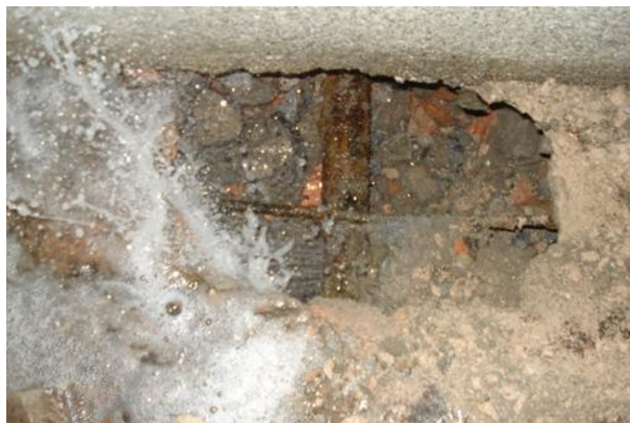
Figura 5. Fuga en el Auditorio C.E.D.E.M. de la Facultad de Economía de CU.
