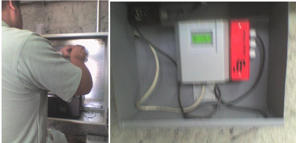
Figura 9. Medidor Electromagnético en Tanque Bajo, Lado Norte y Sur, respectivamente.
