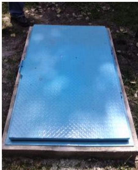
Figura 14. Tapa de registros bajo las recomendaciones de PUMAGUA.
