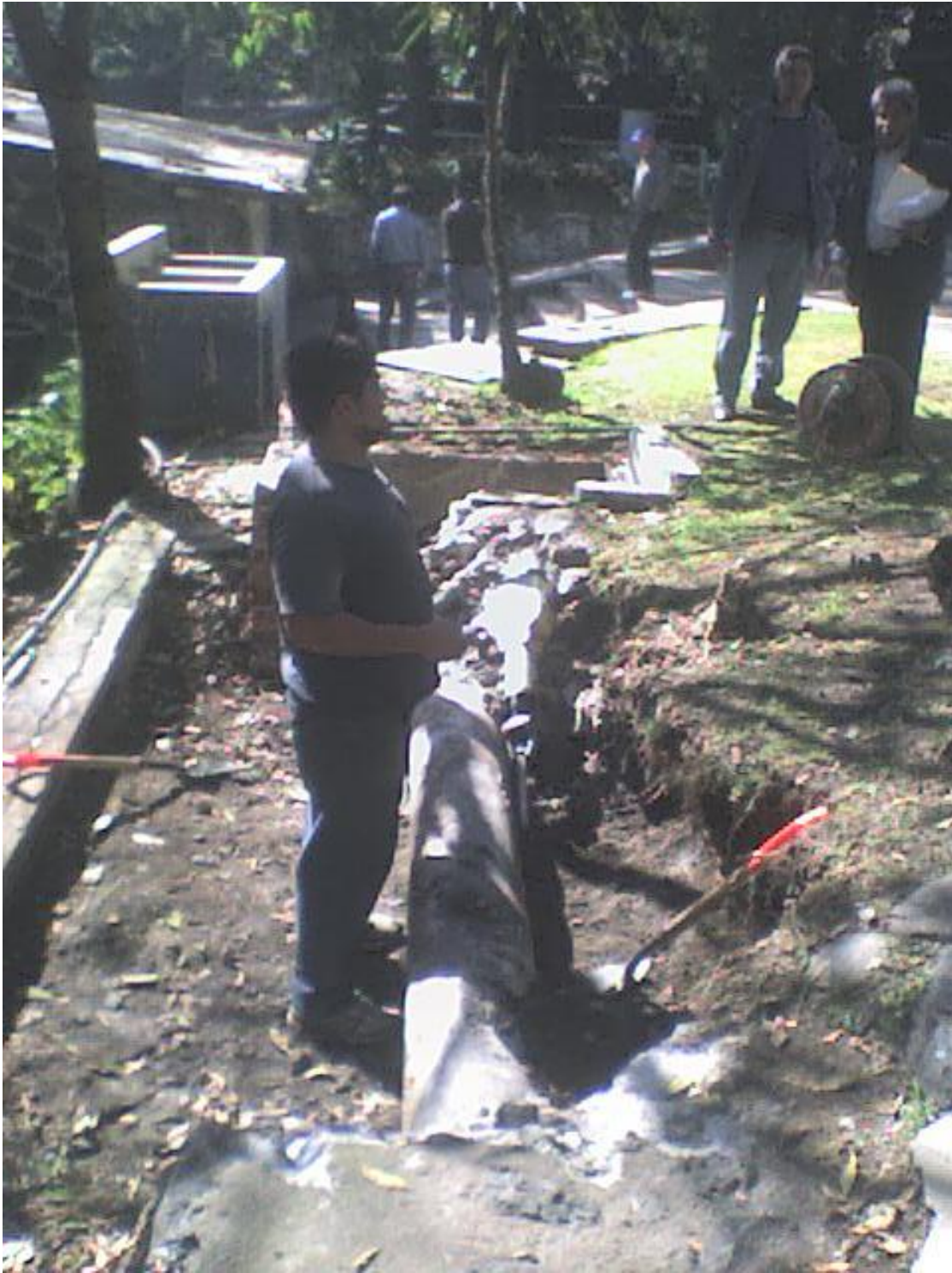
Preparaciones para la instalación de los medidores en Tanque Bajo. Lado Norte
