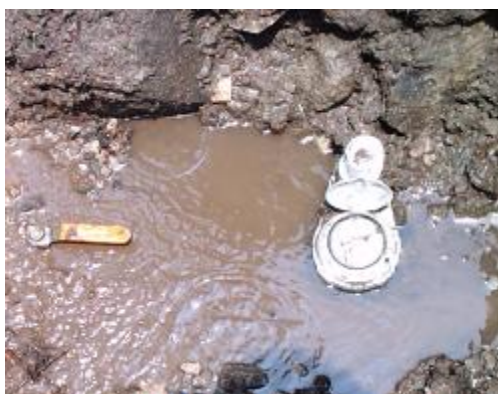
Figura 9. Medidor expuesto a sumersión y humedad.
