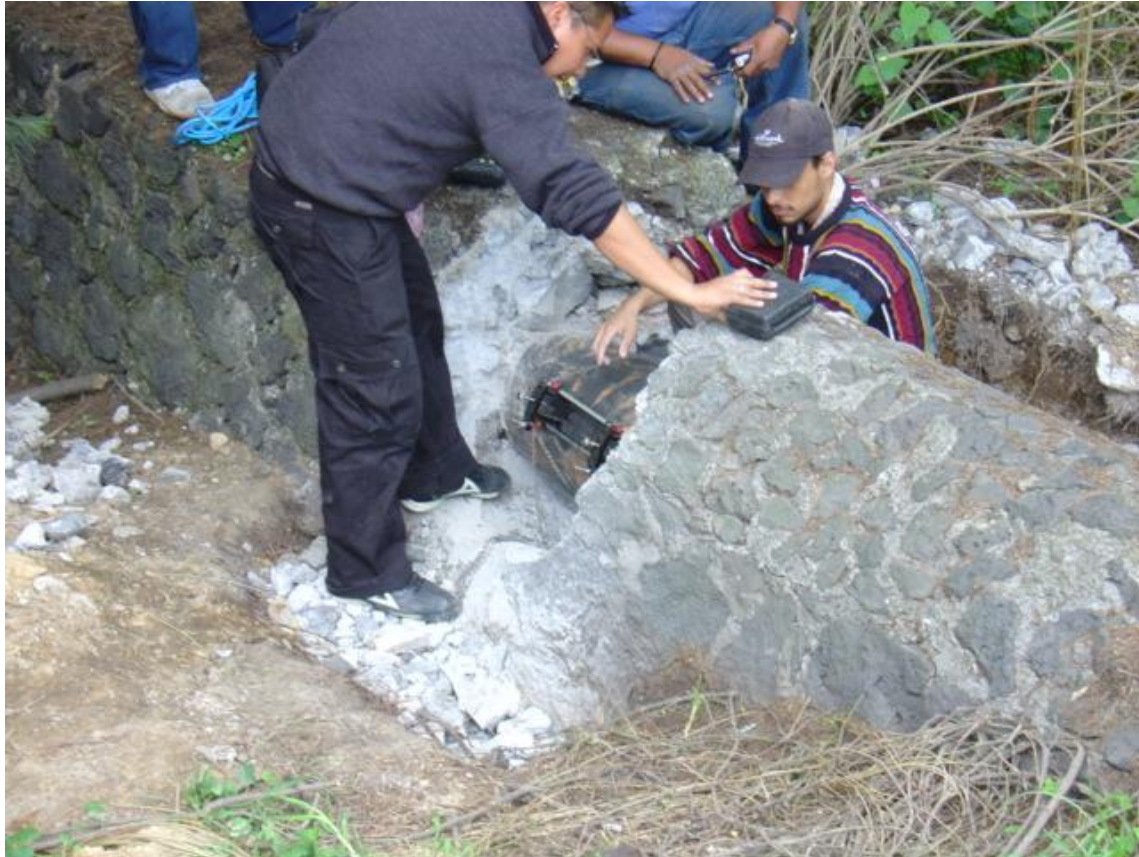
Figura 18. Colocación de medidor y medición de pérdidas en el Sector 2.
