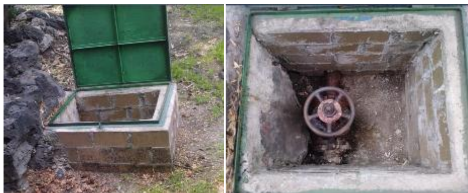
Figura 7. Toma de agua potable con poca disponibilidad de espacio, vulnerabilidad de robo y una gran existencia de árboles.
