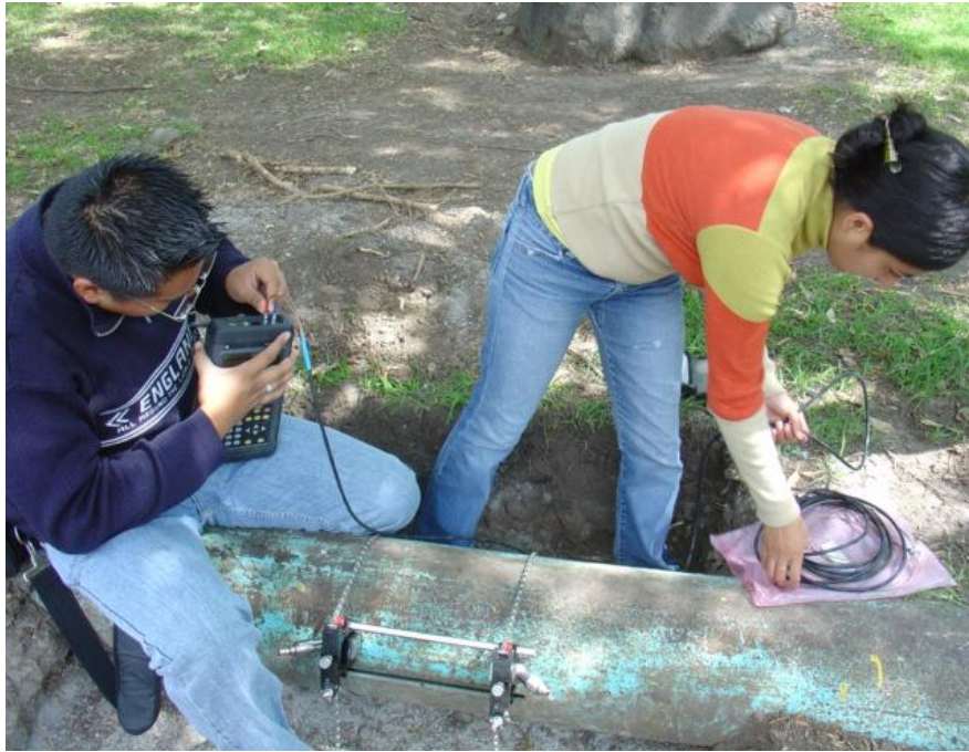
Figura 20. Colocación de medidor y medición de pérdidas en el Sector 3.
