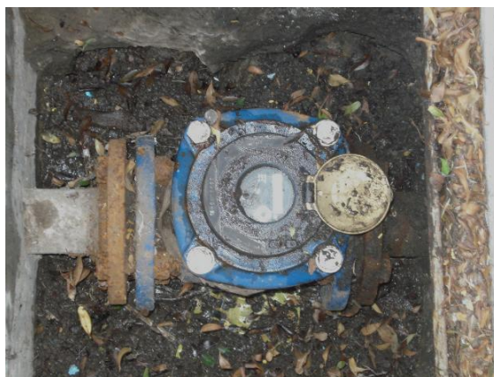
Figura 3. Medidor de 2", encontrado en la zona de Rectoría (Sector 2), el cual no funciona.
