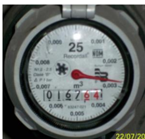
Figura 3. Medidor en funcionamiento
