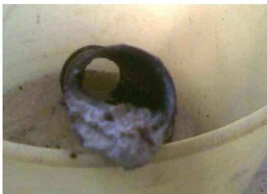
Figura 8. Incrustación en una tubería.
