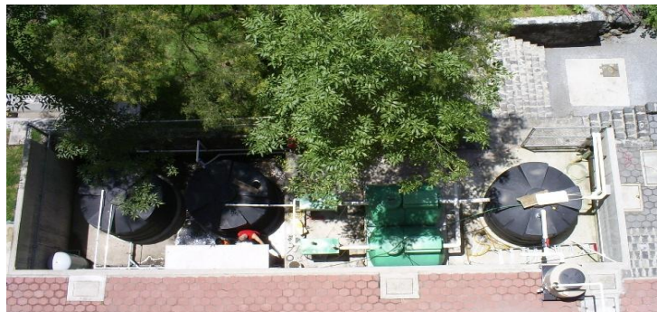
Figura 47. Planta de Tratamiento del edificio 12 del Instituto de Ingeniería
