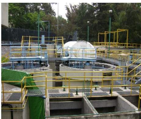
Figura 35. Planta de Tratamiento de Cerro del Agua.
