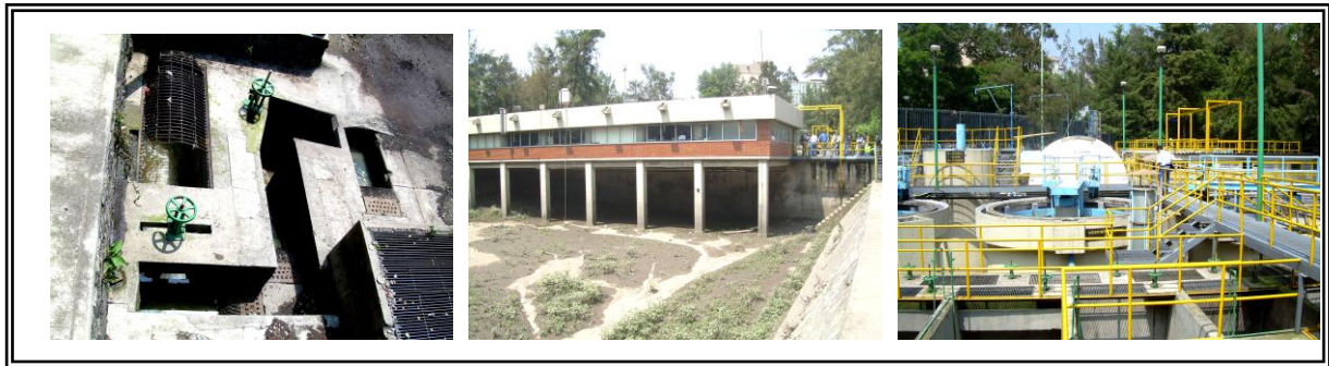
Figura 12. Planta de tratamiento de aguas residuales Cerro del Agua
