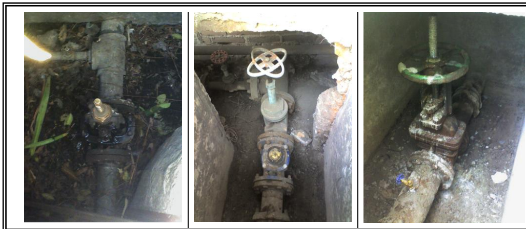
Figura 10. Estado actual de los componentes de la red de distribución
