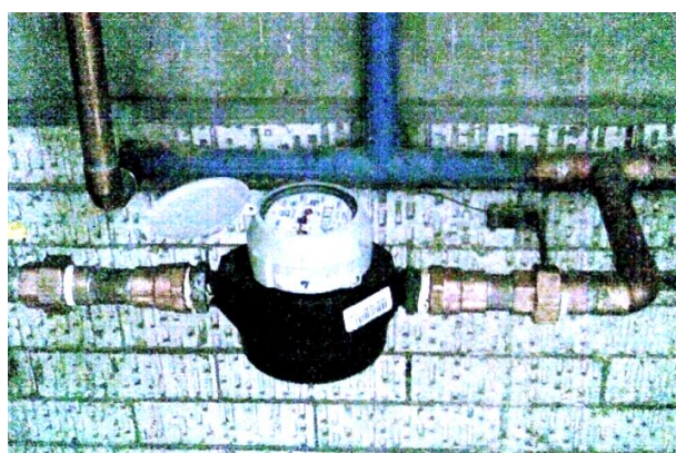
Figura 85. Medidores Instalados en el edificio 5 para medir el consumo de los muebles de baño.
