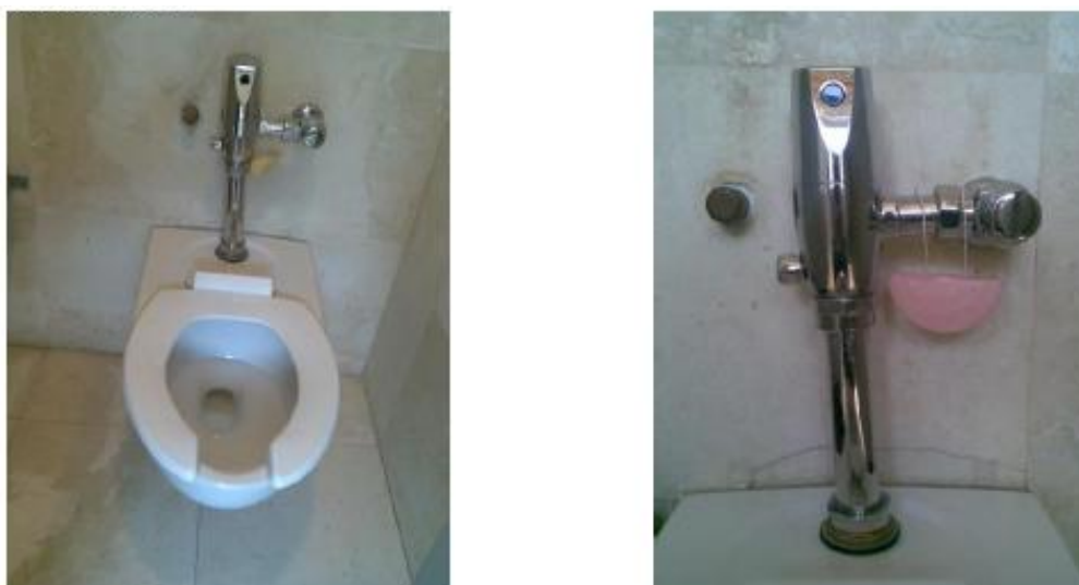
Figura 89. Nuevos modelos instalados. Este conjunto consume en promedio 4.95 lpf
