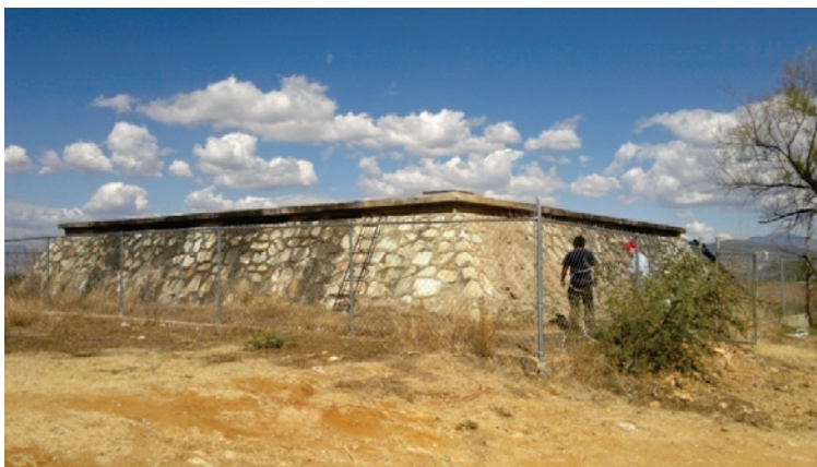
Ilustración G - 4. Tanque de Regulación
