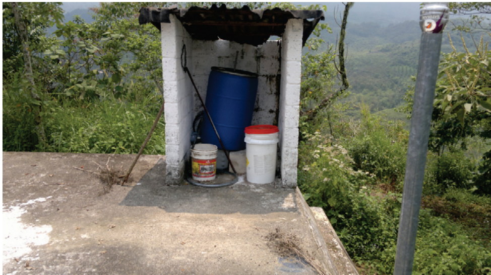
Ilustración G - 3. Sistema de desinfección en el Tanque de Regulación, Cuetzalan del Progreso, Puebla
