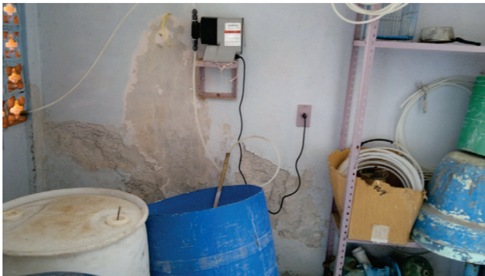
Ilustración E - 3. Sistema de desinfección en los Pozos de El Carmen Tequexquitla, Tlaxcala.
