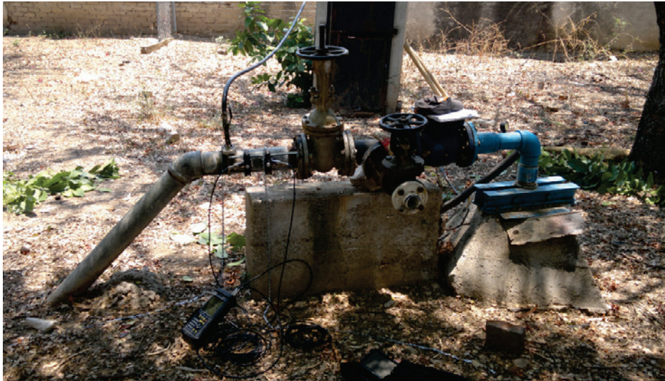
Ilustración H - 2. Medición de gastos en trenes de descarga con el empleo de un medidor ultrasónico o portátil.
