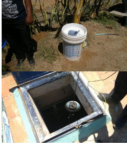
Ilustración B - 3. Sistema de desinfección en los Tanques de Zimatlán de Álvarez, Oaxaca
