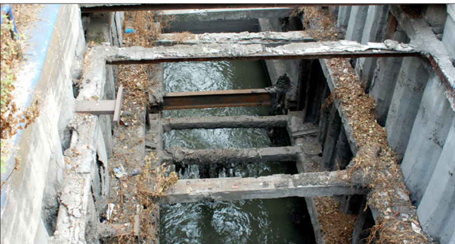
Infraestructura en mal estado.
