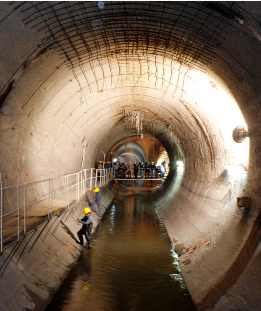
Drenaje profundo en deterioro.
