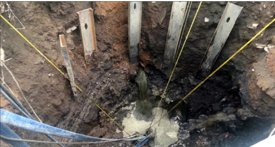
Estructura hidráulica deteriorada.
