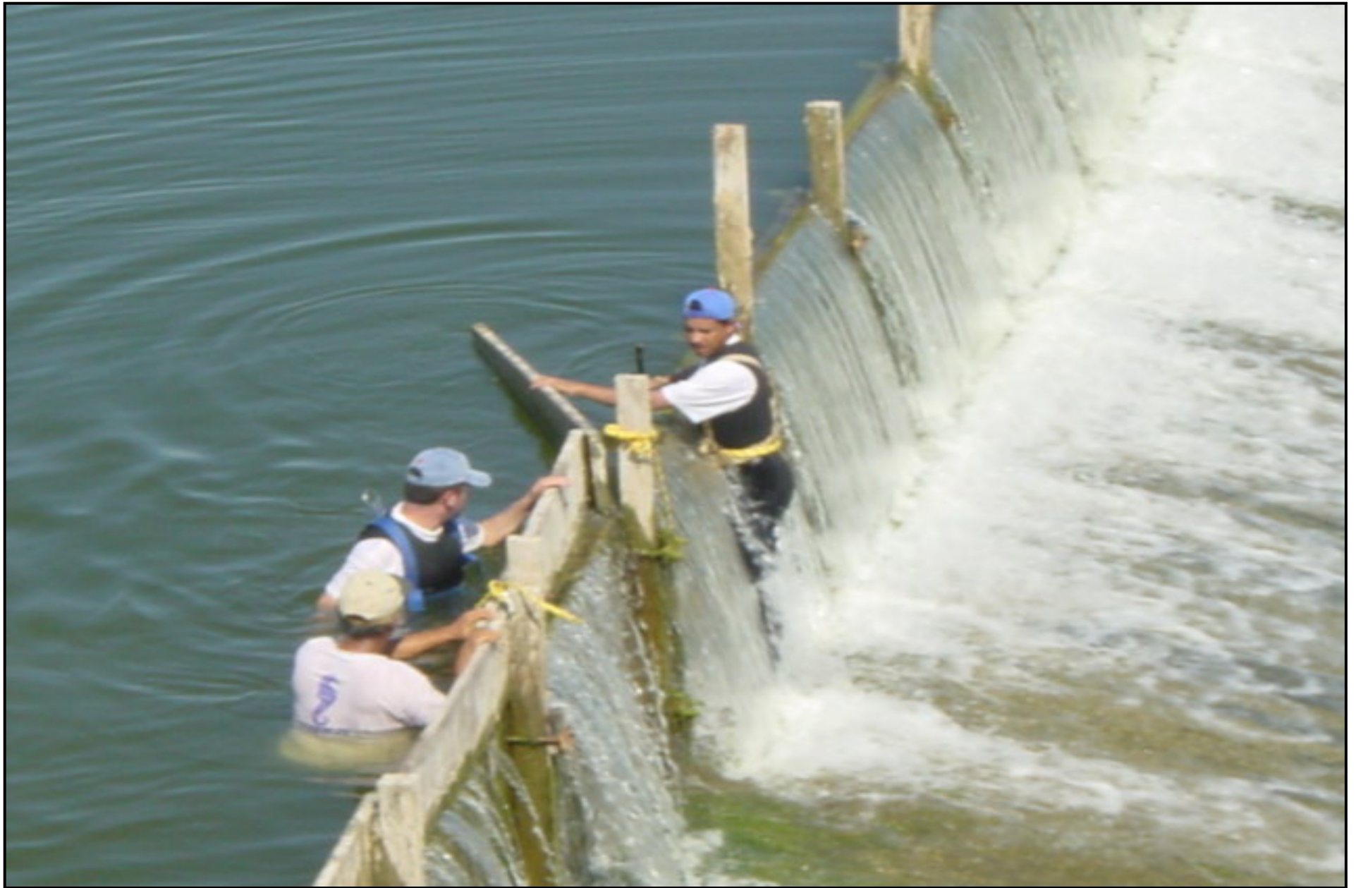
Retiro de agujas en un vertedor de cresta libre
