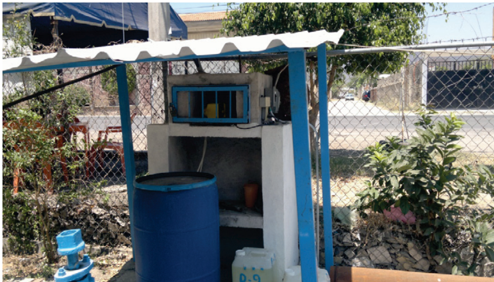
Ilustración F - 3. Sistema de desinfección en los Pozos de Izúcar de Matamoros, Puebla
