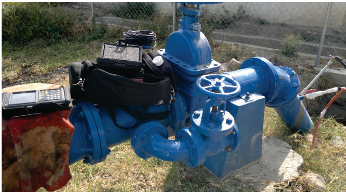
Ilustración F - 2. Medición de gastos en trenes de descarga con el empleo de un medidor ultrasónico o portátil.
