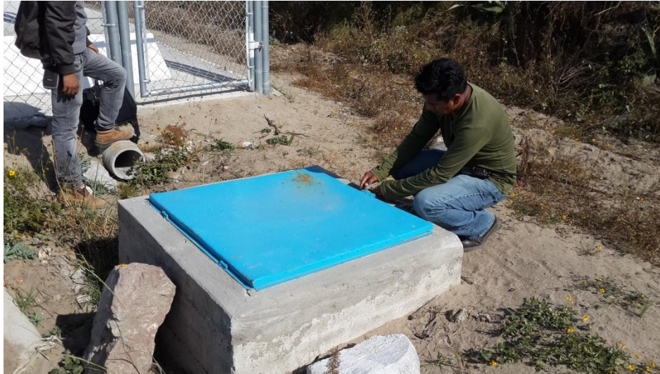
Ilustración 10 Registro a la llegada del tanque.
