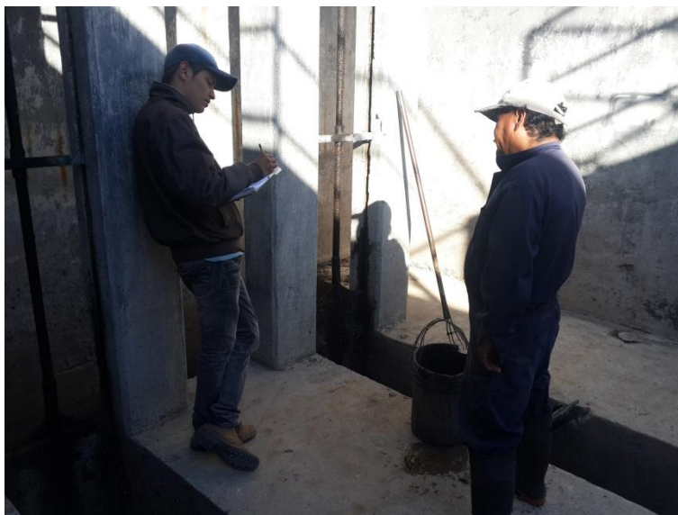
Figura 4 Aforo de un canal Parshall.
