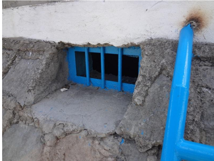
Ilustración 4 Rejilla de ventilación tanque Moctezuma.
