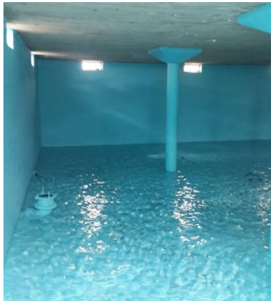
Ilustración 11 Vista al interior del tanque Totolcingo.
