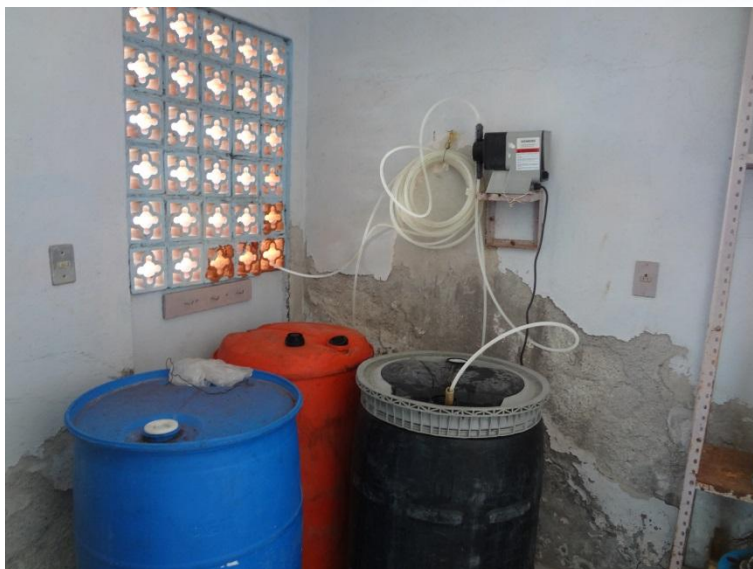
Ilustración 3 Equipo de cloración.
