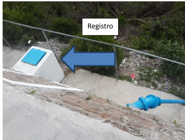
Ilustración 4 Tubería de llegada al tanque.
