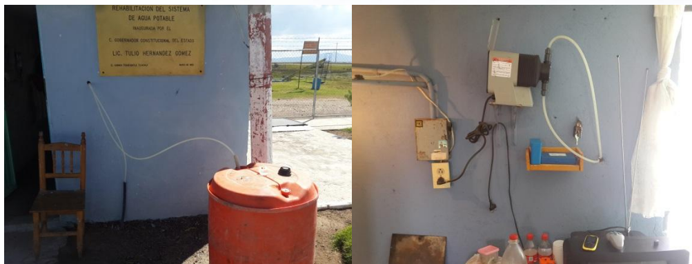
Ilustración 4 Equipo de cloración.
