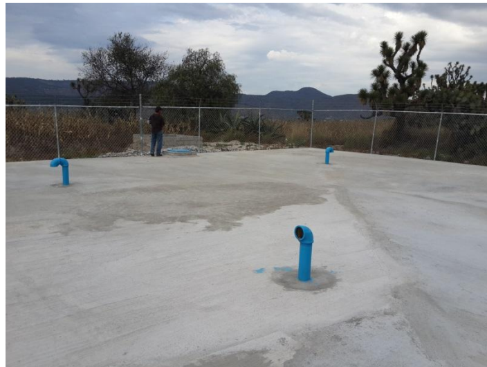
Ilustración 7 Ventilación Tanque Teteles.
