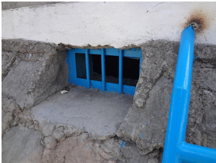
Ilustración 8 Rejilla de ventilación tanque Totolcingo.
