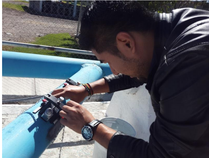
Ilustración 6 Colocación de Ultrasónico.
