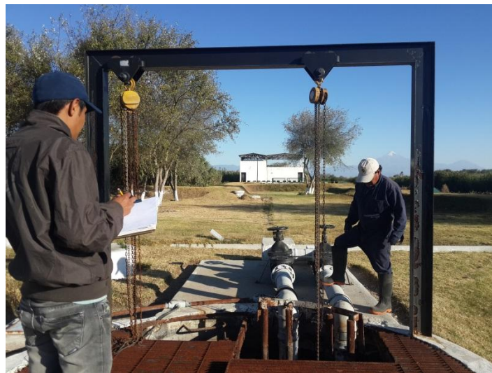
Figura 6 Equipo de bombeo.
