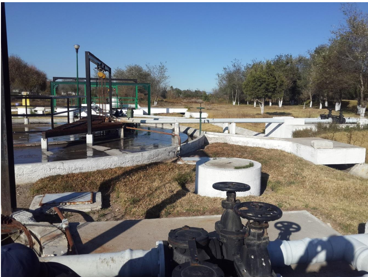
Figura 1 Planta de tratamiento.
