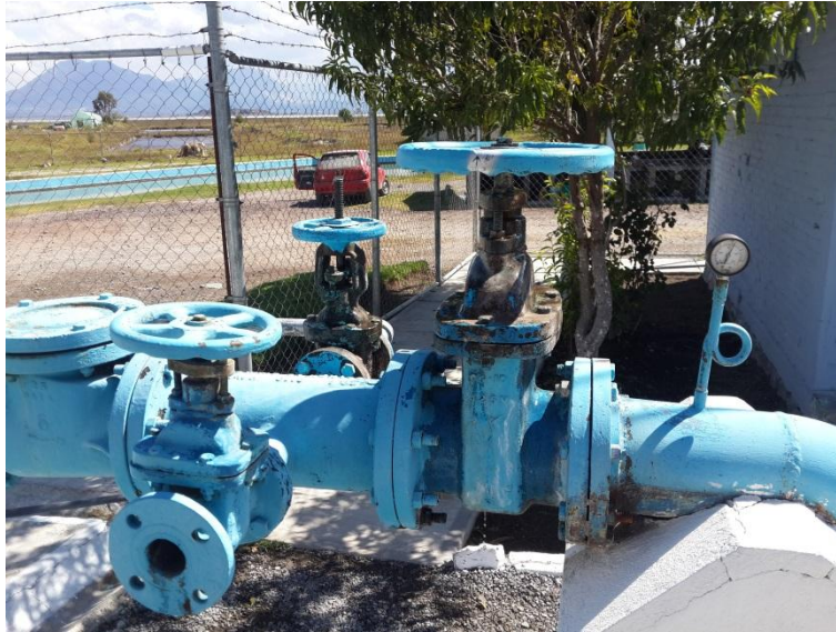
Ilustración 3 Accesorios de la obra de captación.
