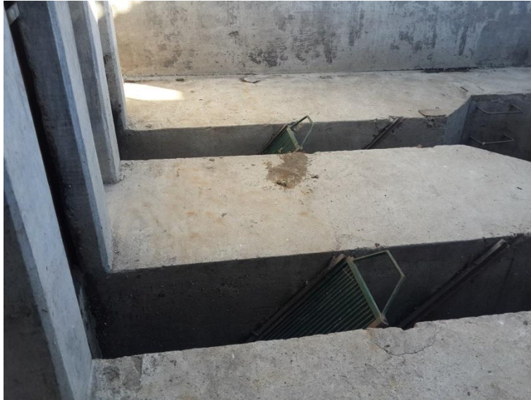
Figura 3 Canales tipo Parshall.
