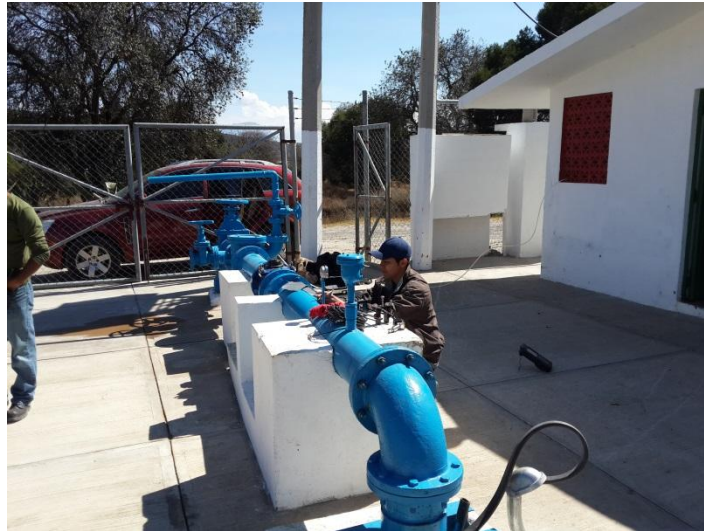
Ilustración 5 Colocación de Ultrasónico.
