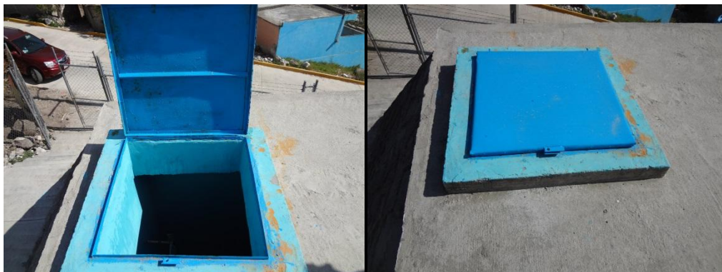
Ilustración 5 Registro de acceso al tanque.
