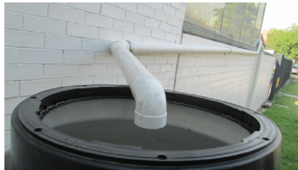
BAJANTE DE 3" Y TINACO
